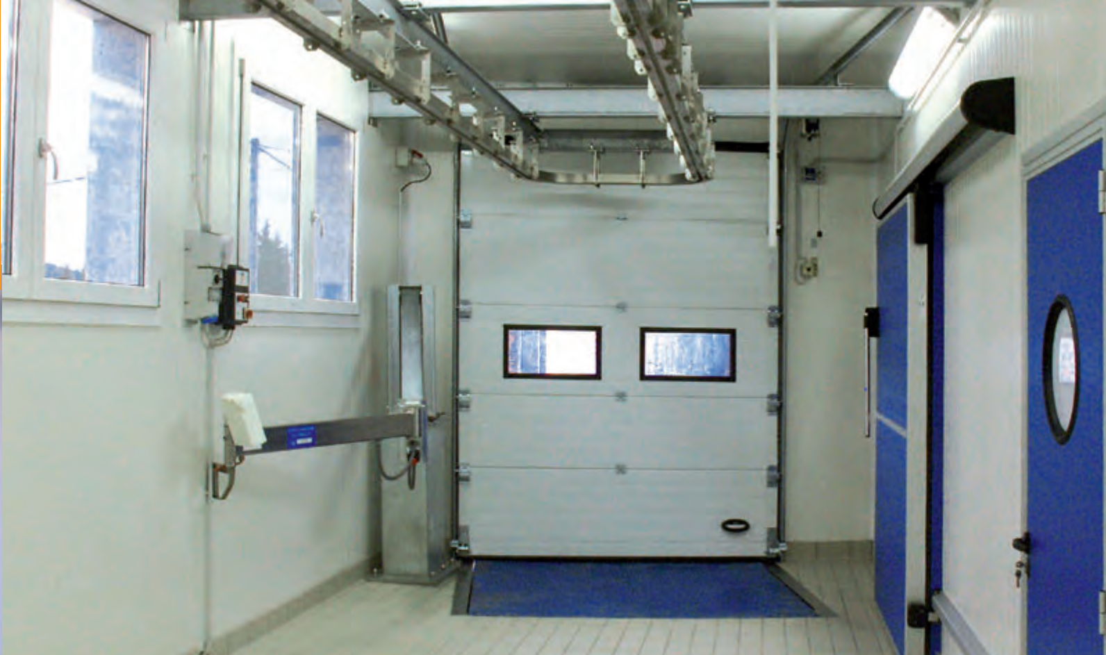
Zona spedizione con portone sezionale, pedana idraulica e braccio di carico Dispatch area composed by sectional door, lifting platform and loading arm
